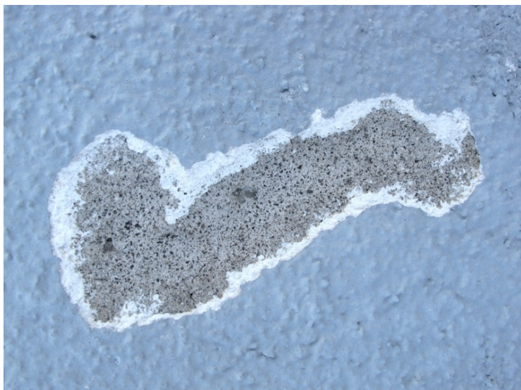
Рисунок 2: Разрушение оштукатуренной стены от воды.
